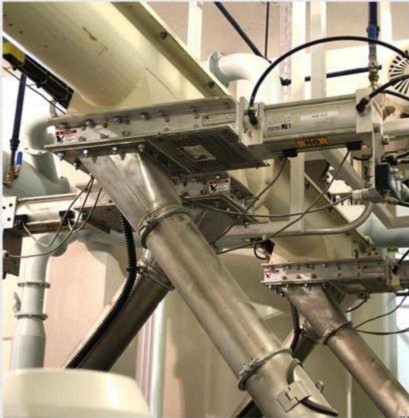
Задвижка 13" (330мм) установлена под шнековым транспортером
