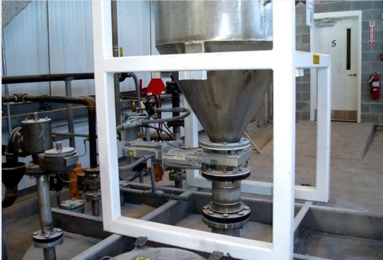
Задвижка 8" (203мм) установлена под бункером с полистирольными гранулами
