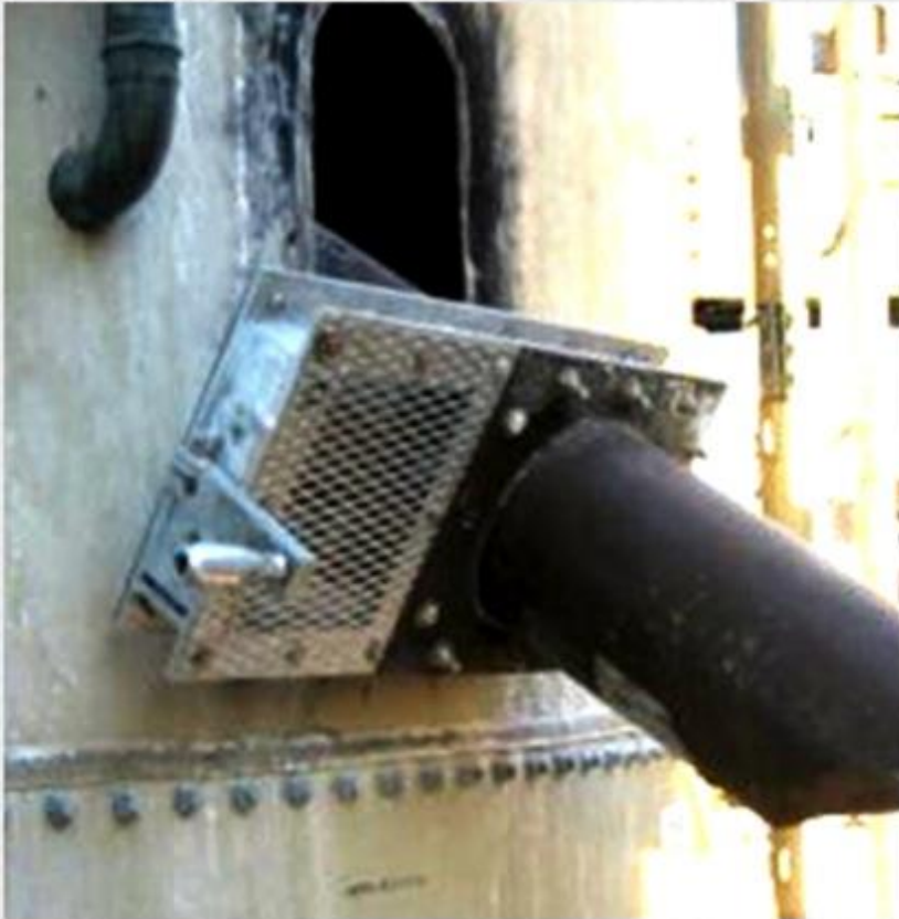
Задвижка 8" (203мм) работает как отсекатель сливной трубы на силосе
