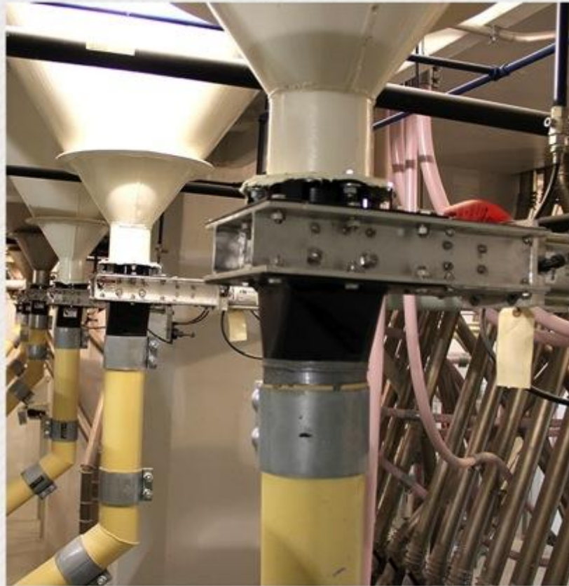
Задвижка 6" (152мм) установлена под силосом с мукой
