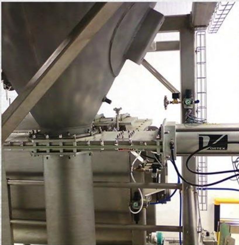
Задвижка 10" (254мм) работает с порошковым цементом
